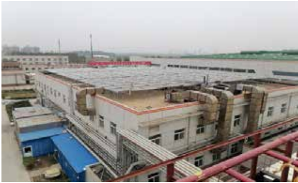
Solar Panels 太陽能集熱設備
